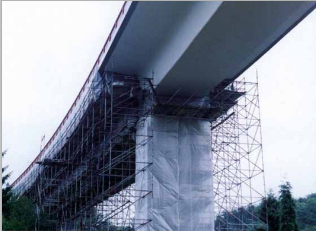
Репрофилиране на носещата подпора на мост с помощта на смес TS 200 и на смес за финална обработка TS 310 на фирма Кнауф.
