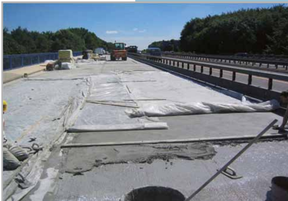
Пример за репрофилиране и саниране на повърхност на пътен мост, предназначена за движение.
